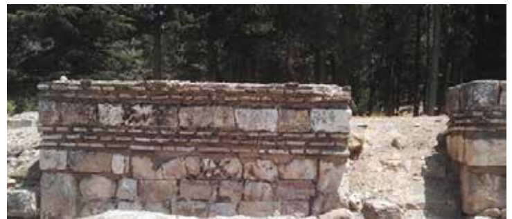
Mauerrest entlang des Cardo; in diesem Wechsel von Werkstein und Ziegel sind nahezu alle Bauten in Anjar ausgeführt.
